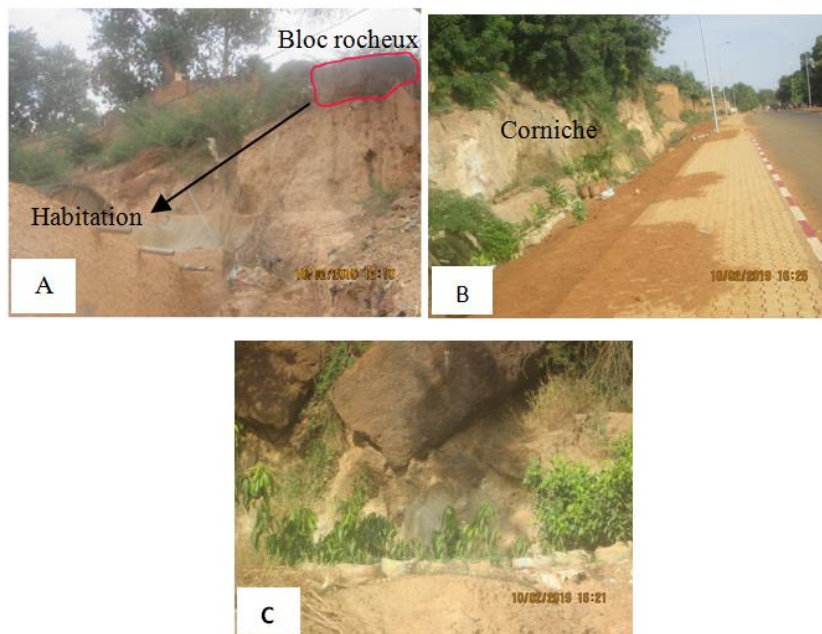
Figure 2 : Facteurs d'exposition des riverains des corniches et de leurs biens (A = bloc rocheux suspendu au-dessus d'une habitation, B = voie longeant la corniche de Yantala, C = blocs suspendus au-dessus des plantes)
